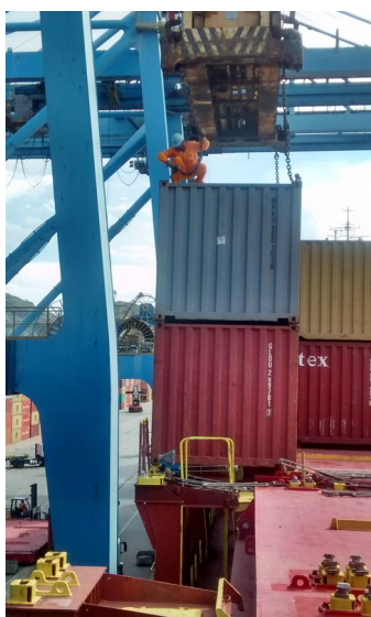
Figuras 12: Fixação de corrente em olhal do contêiner sem cinto de segurança ou qualquer outro dispositivo de proteção ao trabalho em altura
