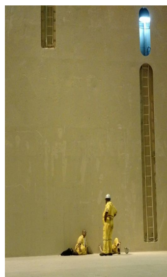
Figura 10: Escada Reta com ausência de cabo-guia
